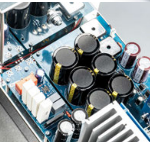
Sekcja filtracji napięć w jednej z połówek wzmacniacza. Transformatory zamknięto w stalowych obudowach.
